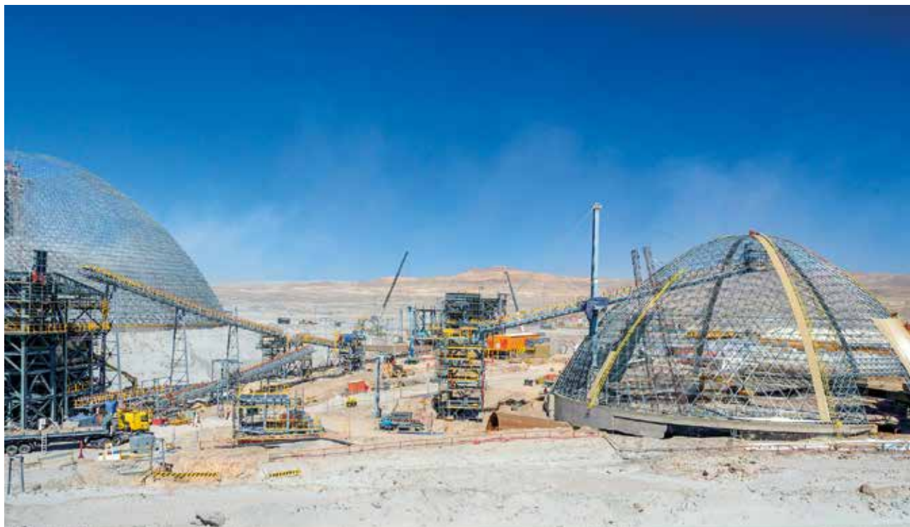
Línea de Chancado secundaria y terciaria Metso/ Minera Centinela, Sierra gorda, Región de Antofagasta – Chile.
