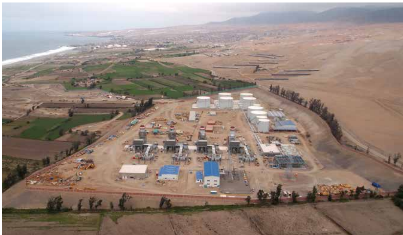
Puerto Bravo Simple Cycle Project 616 MW, Mollendo - Perú
